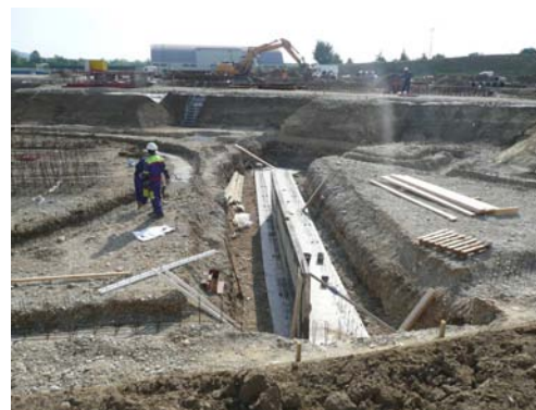
« Les carnots », gaines d'air pour les ventilations des galeries souterraines.
